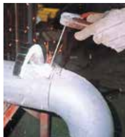
運転中の溶接スモークの状態
