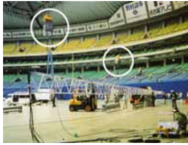
■大型スクリーンの吊上装置
